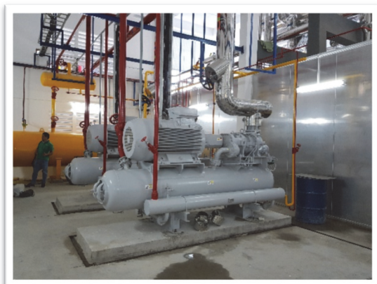
Hệ thống nước lạnh nhà máy sữa
