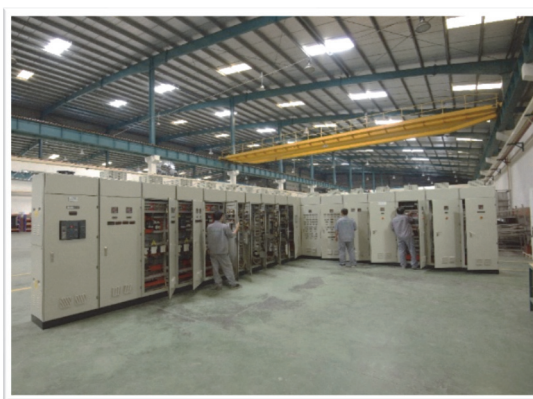
Khu vực lắp đặt tủ điện
