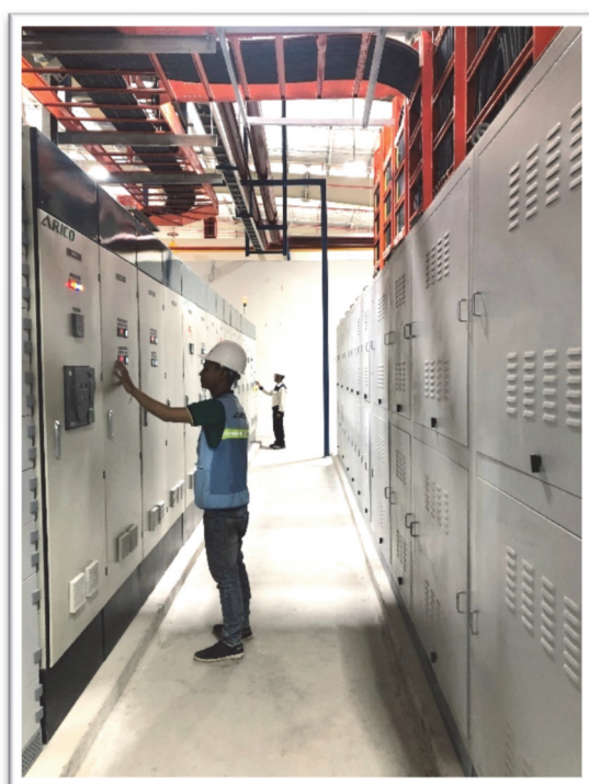
Vận hành hệ thống điện
