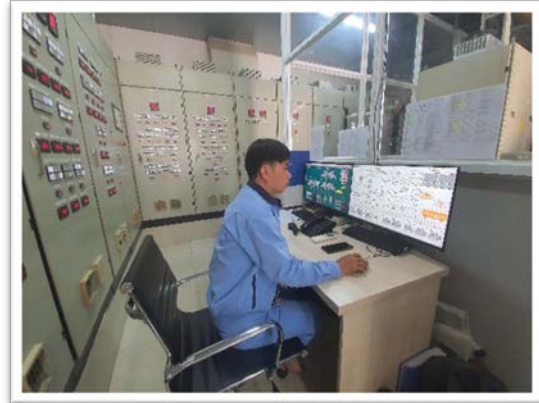
SCADA cho hệ thống lạnh
