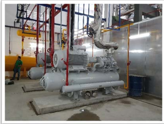
Hệ thống nước lạnh nhà máy sữa
