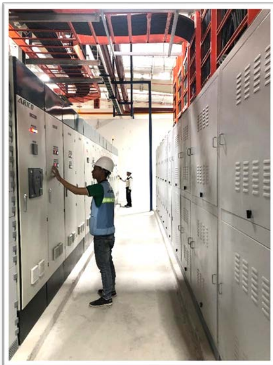
Vận hành hệ thống điện
