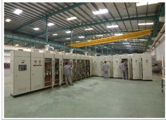
Khu vực lắp đặt tủ điện
